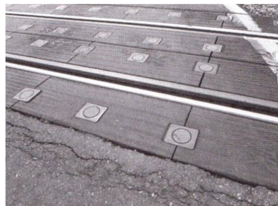
写真 1-6 踏切の線路を横断するとき
